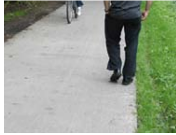
Fig. 2.1.3n Let ook op dat de berm op gelijk niveau met de verharding ligt en niet lager. Dit geeft een risico op valpartijen. Onderhoud het groen ook op tijd: brandnetels fungeren niet als natuurlijke gidslijn!
